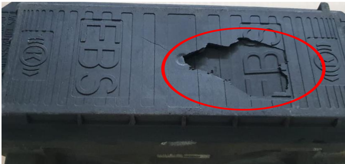
USZKODZONA POKRYWA PLASTIKOWA/PĘKNIĘTA/ZŁAMANA/UTRĄCONA
