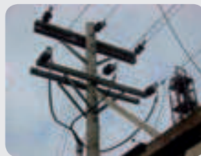
Defekt linii przesyłowej
